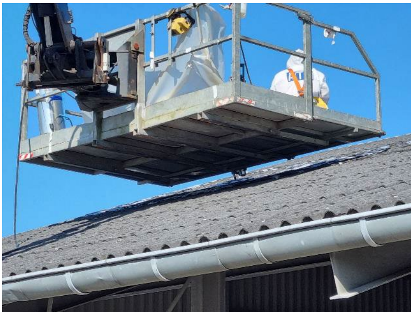
Foto 13: Losschroeven asbestcement golfplaat
